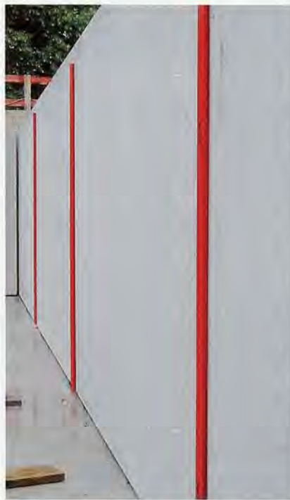
Massenweise: Auf der Baustelle Museumsdepot in München sind insgesamt 7.000 m Hohlwandstoß abzudichten – da lohnt sich ein schnelles und sauberes System wie die Fluxx-Stoßabschalung auf jeden Fall.
