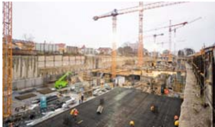
Die Firma Klebl hat sich bei dem Großprojekt Pasing Arcaden für die Ischebeck Titan HV Deckenschalung entschieden
